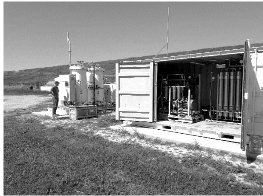
Fig. 4 – L'impianto di upgrading del biogas a biometano presso la discarica di Ravenna, sulla destra il sistema a membrane, sulla sinistra il sistema PSA.
